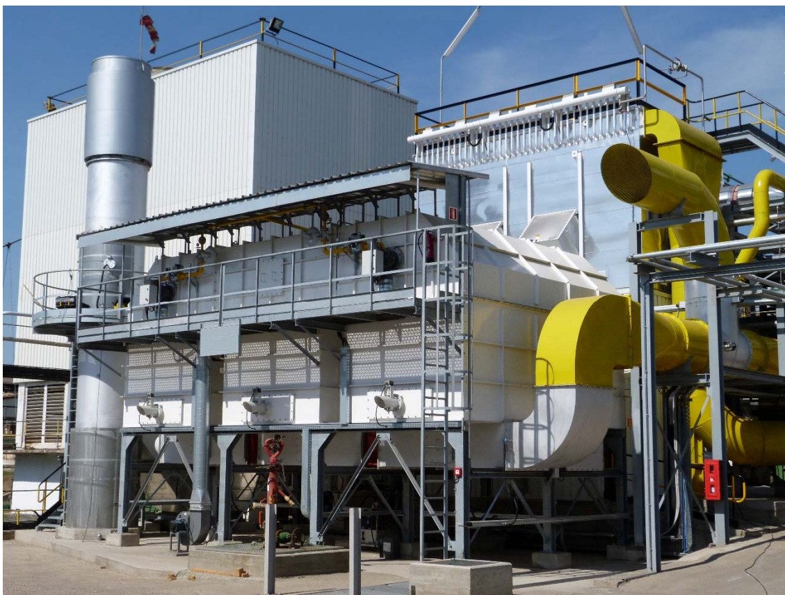
Fotografía 1: Vista de un termorreactor.
