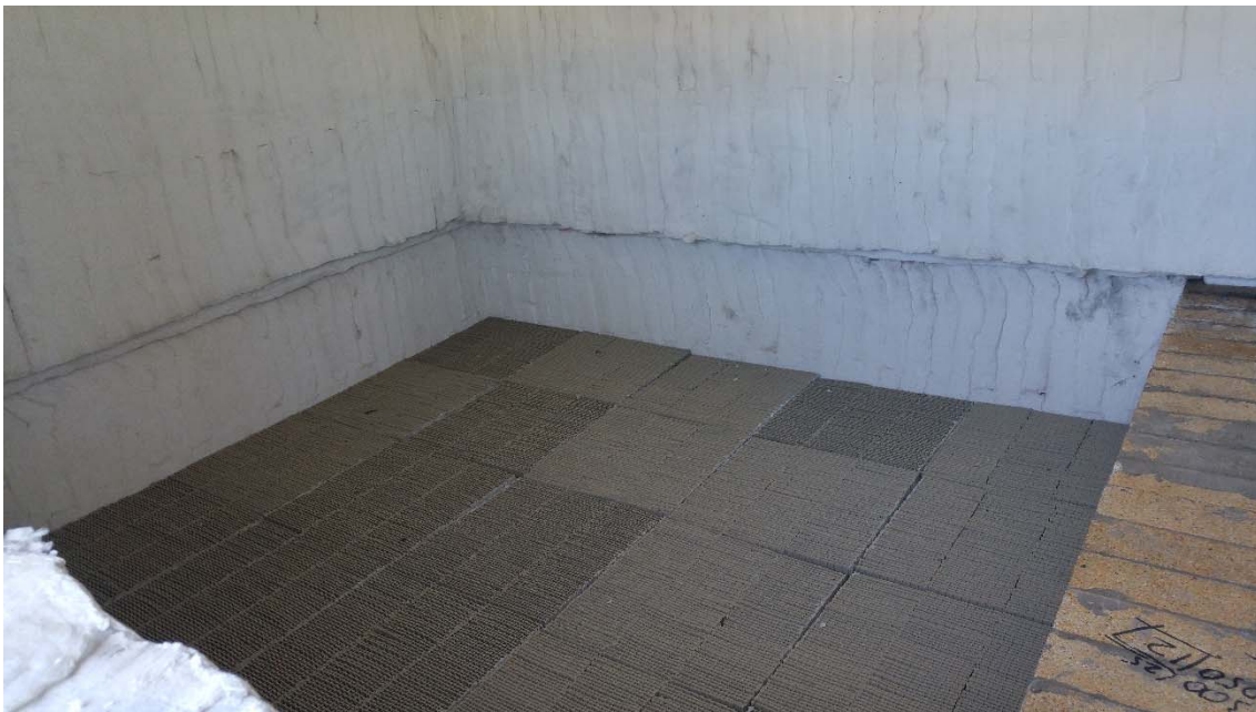
Fotografía 8: Interior de una torre rellena con MLM.
