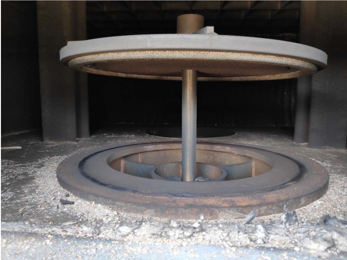
Fotografía 19: Válvula de plato con junta.
