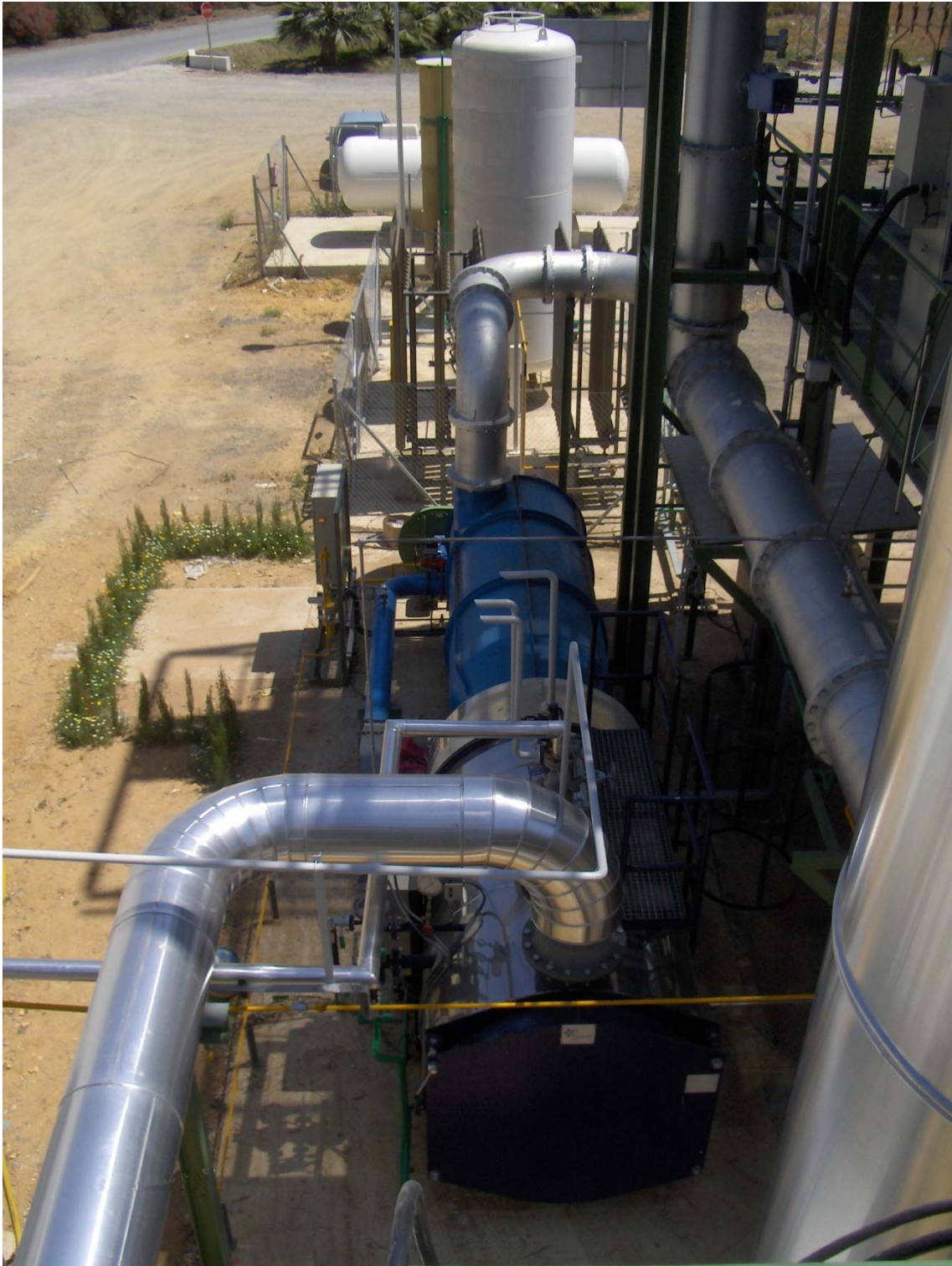
Fotografía 1: Planta de oxidación térmica de gas de síntesis con recuperación de calor para generar vapor.
