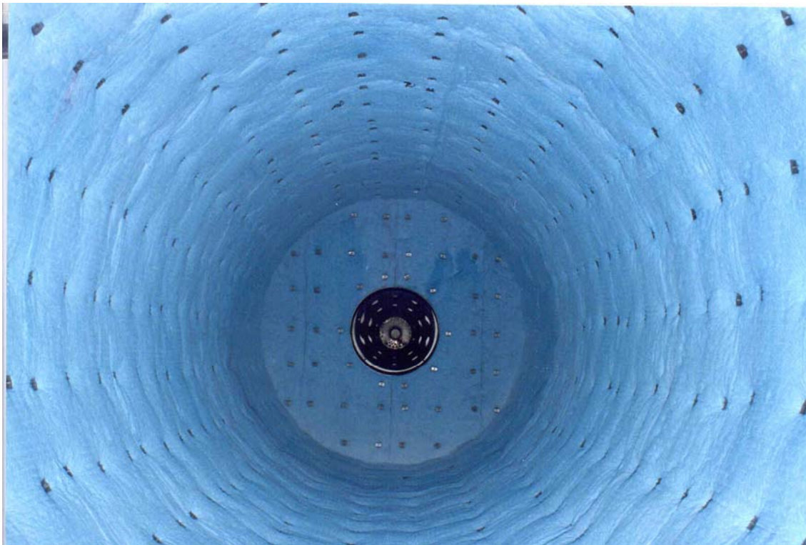
Fotografía 4: Interior de una cámara de oxidación con un quemador de tipo cono.
