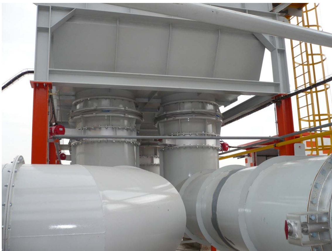
Fotografía 17: Conductos de entrada y salida de un RTO con válvulas de mariposa.
