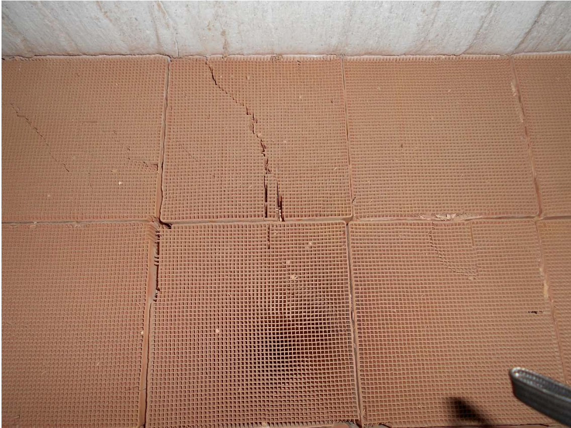
Fotografía 5: Bloques de "Honeycombs" agrietados.
